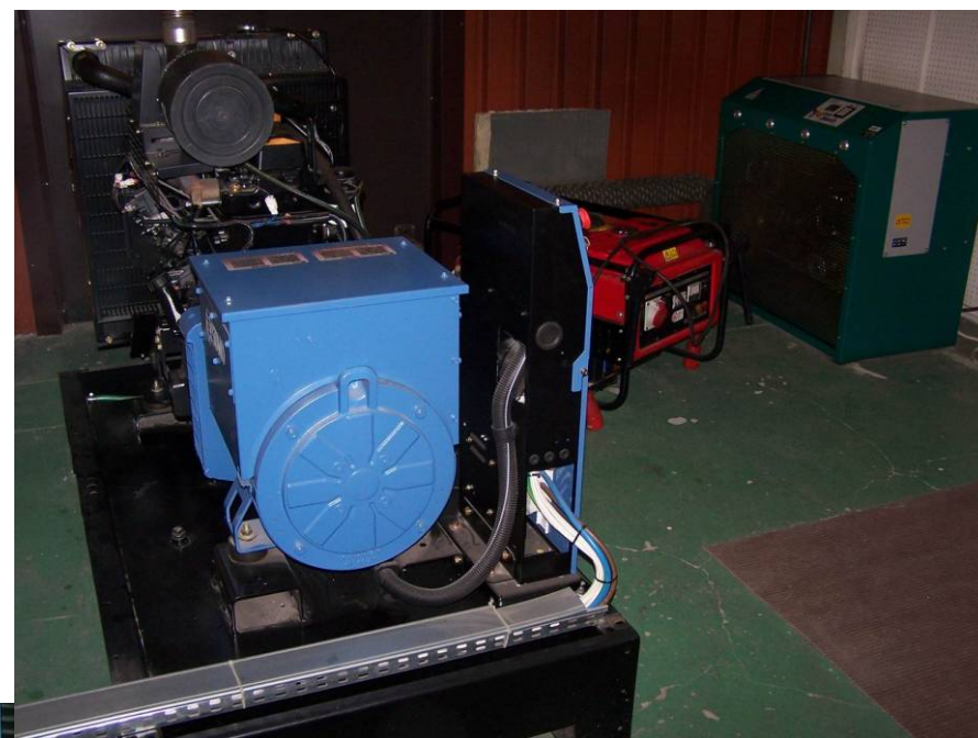
Agregat prądotwórczy – rezerwowe zasilanie budynku oraz sprężarka do sprzętu ODO
