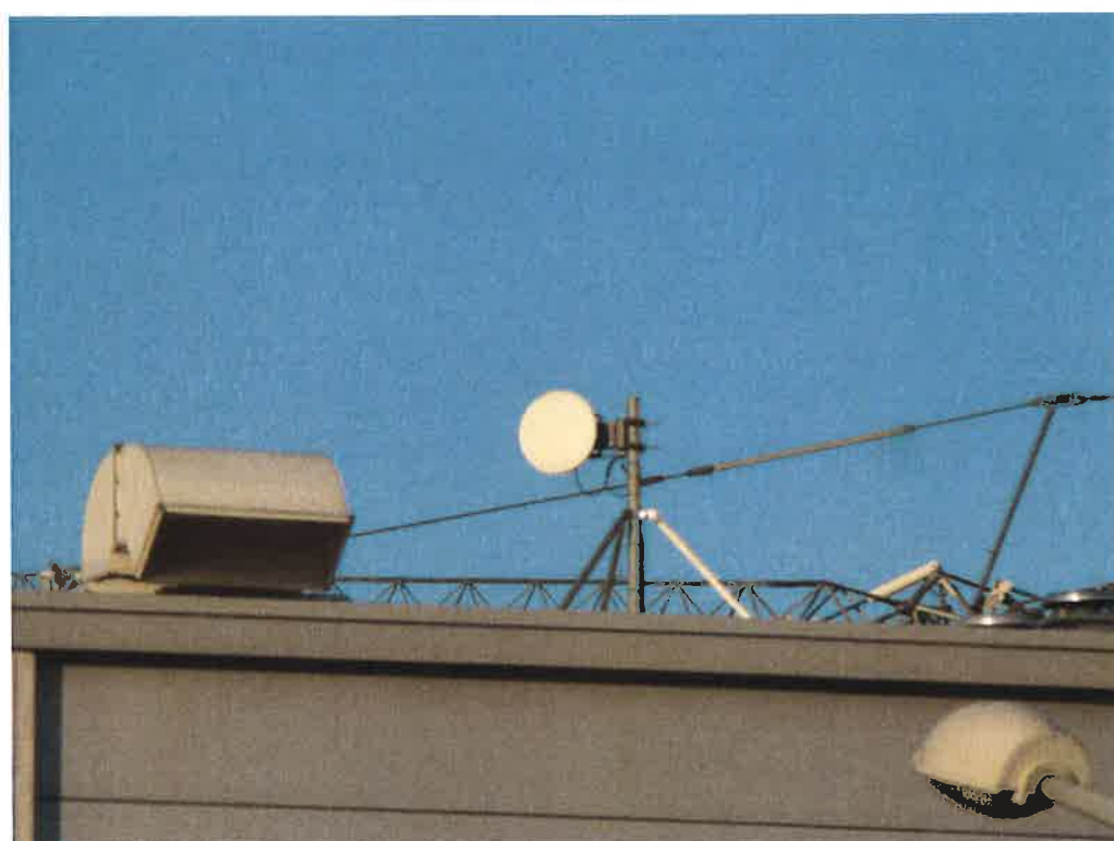
Widok instalacji radiokomunikacyjnej Stacja Netia LESAB010 - LESAM00024 Lesznowola, ul. Jedności 10.
