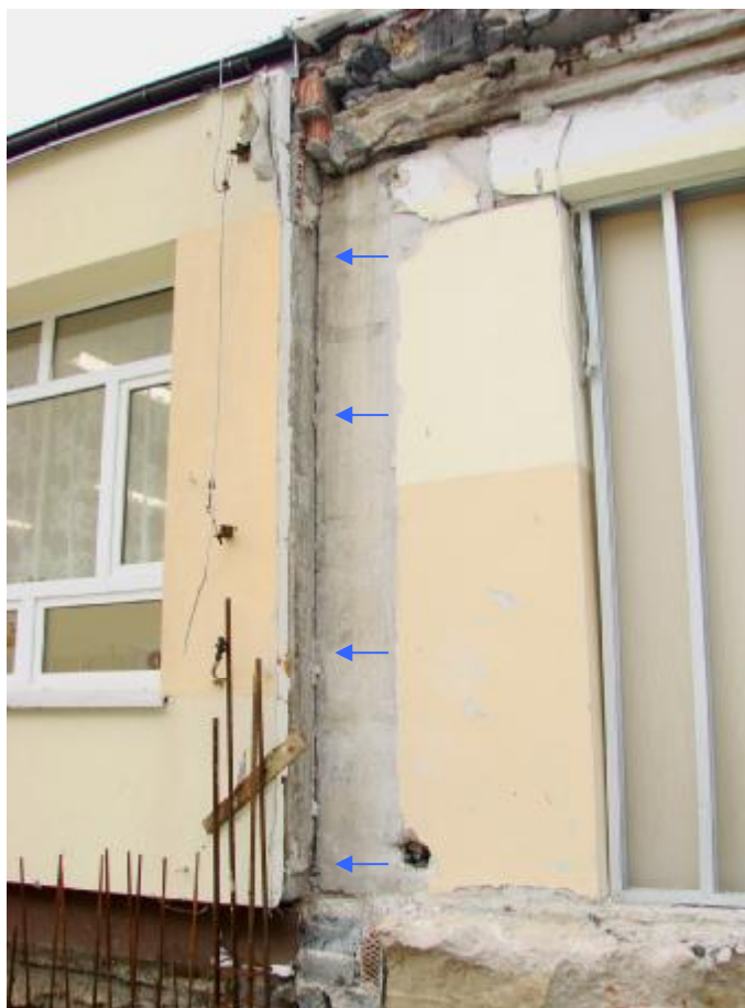
Fot. 7 Na tej samej ścianie, po drugiej stronie rozebranej części łącznika, również widoczna szczelina pomiędzy słupkiem, a ścianą budynku.
