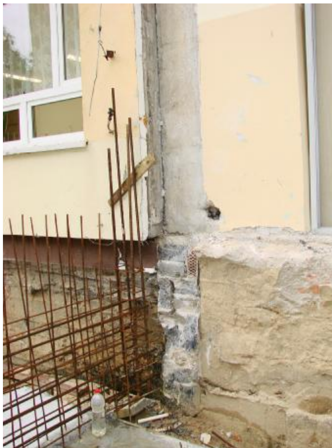
Fot. 9 Po drugiej stronie, na tej samej ścianie w części po rozebranym łączniku (fot. 7) nie występują spękania, ponieważ wykonano fundament bezpośrednio przy istniejącym fundamencie oraz nie pozostawiono zagłębień w wykopie w którym mogła by się zbierać woda deszczowa i podsiąkać pod fundament.
