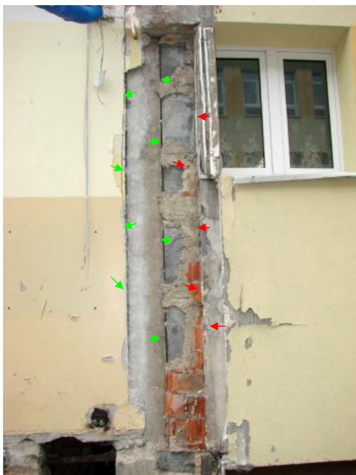
Fot. 4 Spękania widoczne na fot. 1, 2, 3 występują również w tym samym miejscu (zaznaczone tymi samymi kolorami strzałek) na ścianie zewnętrznej. W tym przypadku nie są to spękania, a szczeliny pomiędzy dwoma słupkami żelbetonowymi i ścianami zewnętrznymi budynku. Jeden ze słupków został wyrównany pilastrem z cegły szczelinówki, częściowo już rozebrany.
