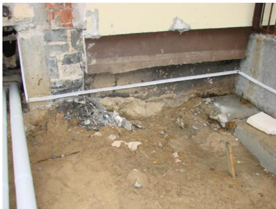
Fot. 8 Widoczne przesunięcie nowo wykonanego fundamentu łącznika oraz zagłębienie pomiędzy fundamentem pod słupkami żelbetowymi a fundamentem. W miejscu tym gromadziła się woda deszczowa, która naruszyła strukturę gruntu powodując spękanie tynków na ścianie w wyniku nieznacznego osiadania fundamentów pod słupkami nie mającymi oparcia.
