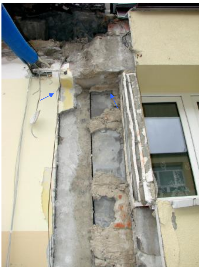
Fot. 6 Na słupkach widoczny fragment nadwieszonoego wieńca stropowego.
