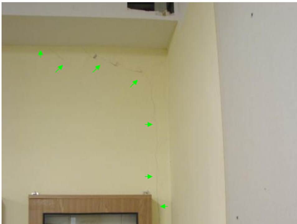
Fot. 3 Spękania ściany widoczne na fot. 1 i 2 widoczne od strony korytarza. Wyraźny ten sam zarys, kierunek i kształt spękania.
