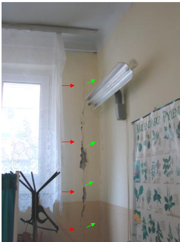
Fot. 1 Pionowe spękania na ścianie. Jedno w odległości 30cm od pachwiny (strzałki czerwone), drugie w pachwinie ściany zewnętrznej i wewnętrznej (strzałki zielone) – widok od strony pomieszczenia gabinetu lekarskiego.
