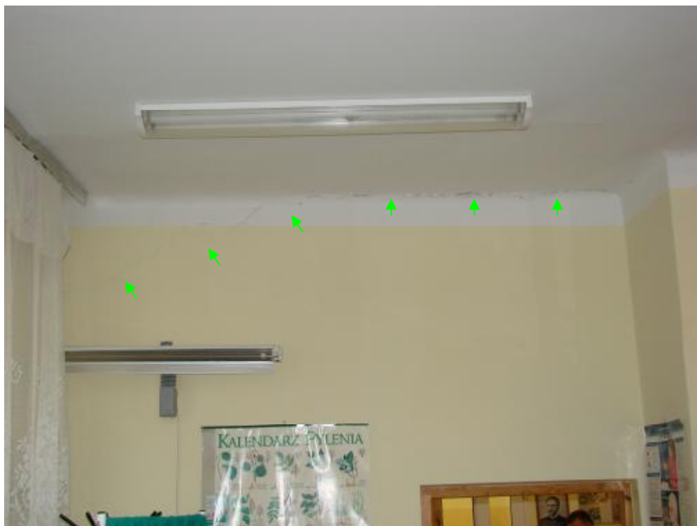
Fot. 2. Spękanie przechodzi z pionowego w poziome w pachwinie stropu ze ścianą – widok od strony pomieszczenia gabinetu lekarskiego.
