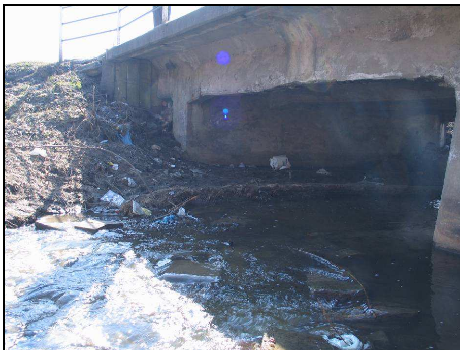
Fot. 24. Widok mostu od strony dolnej wody. Nieuporządkowana przestrzeń pomostowa. Zanieczyszczony i nieumocniony stożek nasypu.
