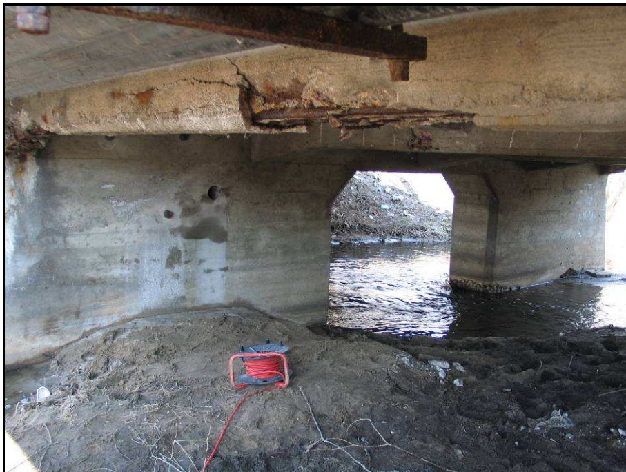
Fot. 17. Bardzo duży ubytek betonu na belce skrajnej od strony dolnej wody w środku rozpiętości przęsła. Ubytek odsłania skorodowane pręty zarówno dolny jak i górny rząd.
