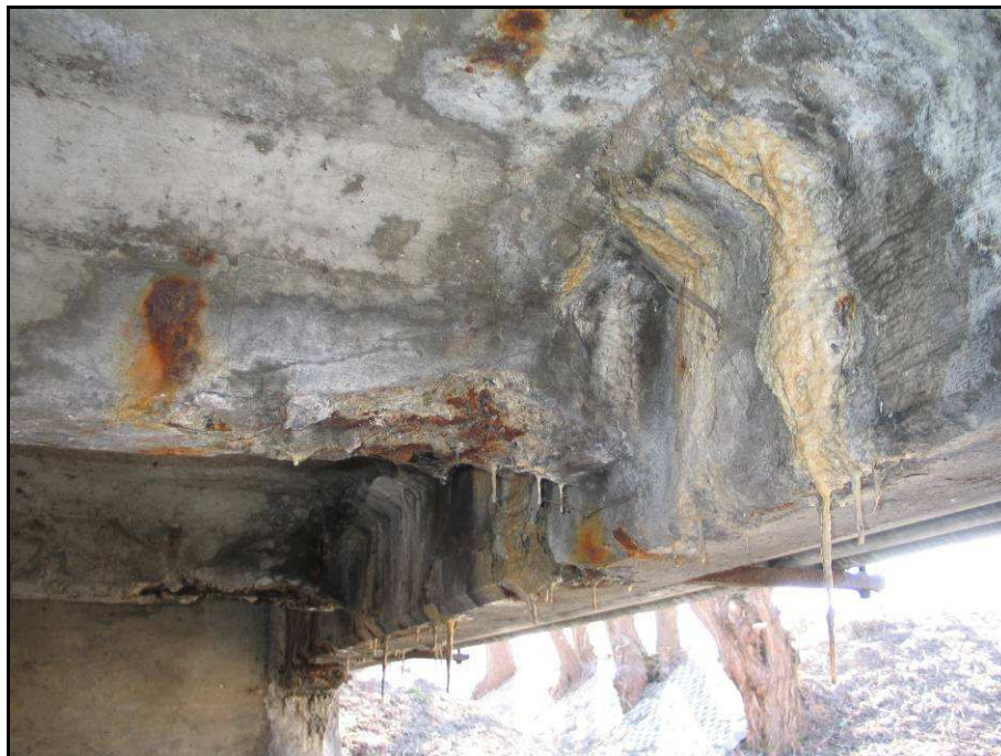
Fot. 13. Zacieki wody, białe wykwity i stalaktyty wapienne, rdzawe wycieki, ubytki betonu, korodująca stal – uszkodzenia występujące na wewnętrznych częściach skrajnych belek oraz na przylegających do nich poprzecznicach i płycie pomostu.
