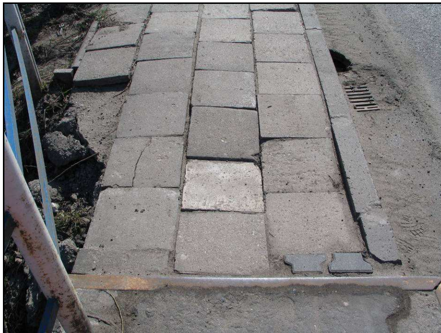
Fot. 21. Zniszczony chodnik na dojściu do mostu od strony Jeziorzan po lewej stronie jezdni. Zniszczeni nastąpiło w wyniku działalności wody, pomimo znajdującej się w tym miejscu studzienki ściekowej.
