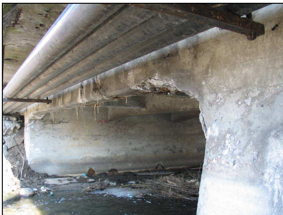
Fot. 16. Belka skrajna od strony centrum Tarczyna (GW). Białe wykwyty, rdzawe wykwyty, stalaktyty wapienne, ubytki betonu, skorodowana stal - uszkodzenia występujące na wszystkich skrajnych dźwigarach.
