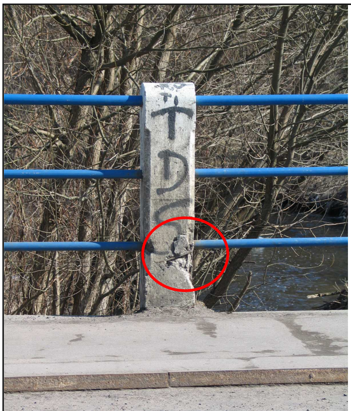
Fot. 9. Ubytki materiału w dolnej części betonowego słupka balustrady.
