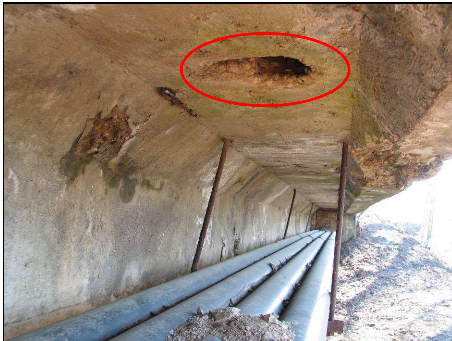
Fot. 11. Wspornik chodnikowy od strony GW. Dziura we wsporniku chodnikowym zakryta nawierzchnią z asfaltu lanego.
