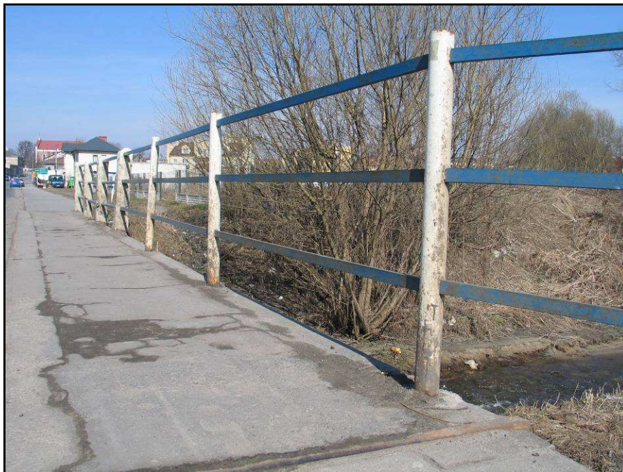
Fot. 7. Chodnik z balustradą od strony DW. Widoczne pęknięcia nawierzchni chodnika. Ogniska korozji na stalowych słupkach i przeciągach balustrady.
