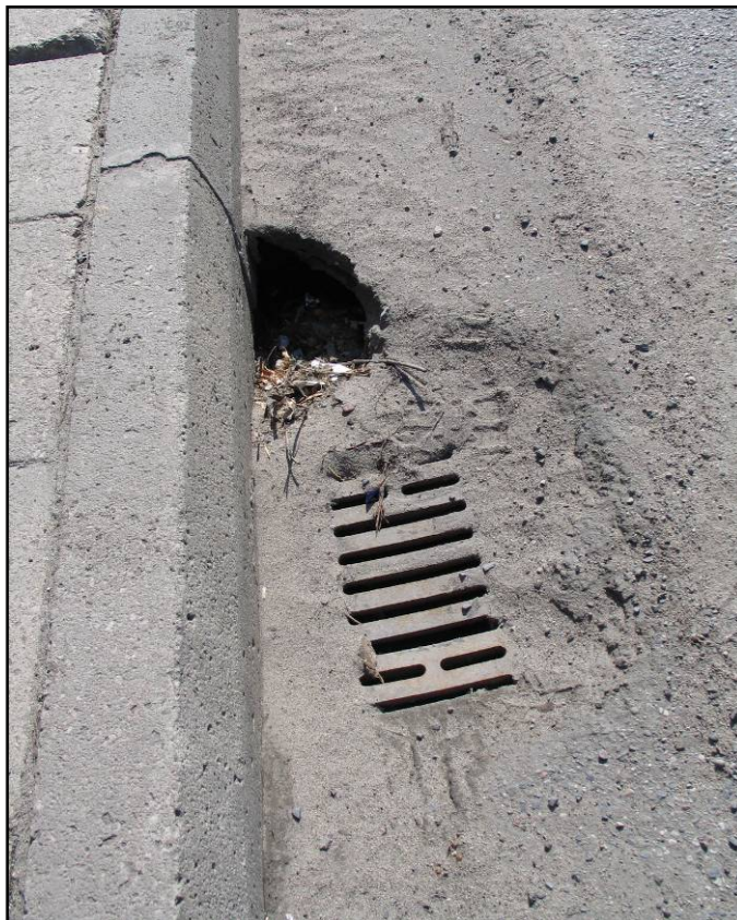
Fot. 23. Zanieczyszczona kratka studni ściekowej na dojeździe do mostu od strony Jeziorzan. Widoczna dziura w nawierzchni jezdni.
