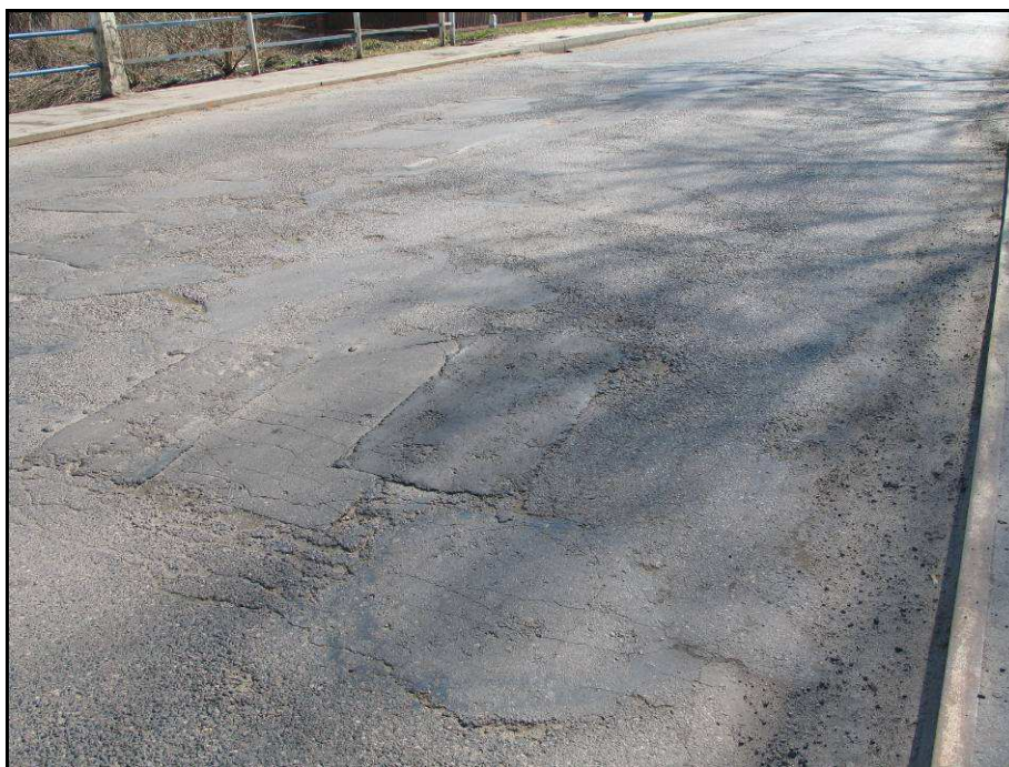
Fot. 8. Nierówności, ubytki, spękania i naprawy nawierzchni na moście.
