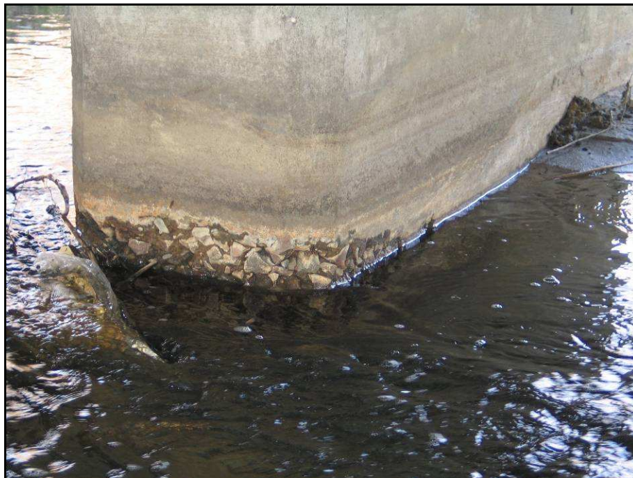
Fot. 19. Ubytek materiału na czole podpory nurtowej od strony GW, na poziomie niskiej wody.
