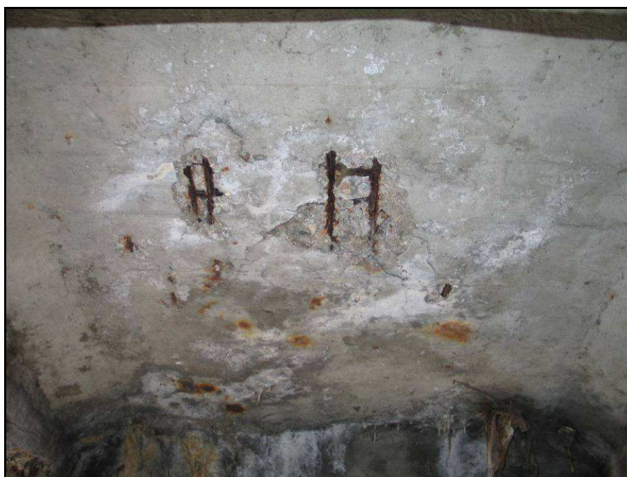
Fot. 14. Spód płyty pomostu pomiędzy skrajnym, a przedskrajnym dźwigarem. Uszkodzenia w postaci białych wykwitów, rdzawych wykwitów, oraz ubytków betonu z odsłoniętymi skorodowanymi prętami.
