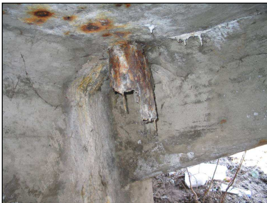
Fot.20. Zdegradowany nieczynny wpust żeliwny, znajdujący się przy podporze skrajnej.
