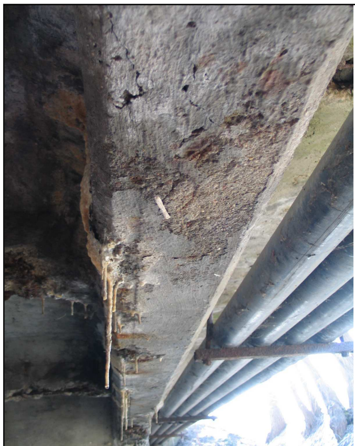
Fot. 12. Widoczne stalaktyty wapienne na wewnętrznej stronie belki skrajnej od strony GW.
