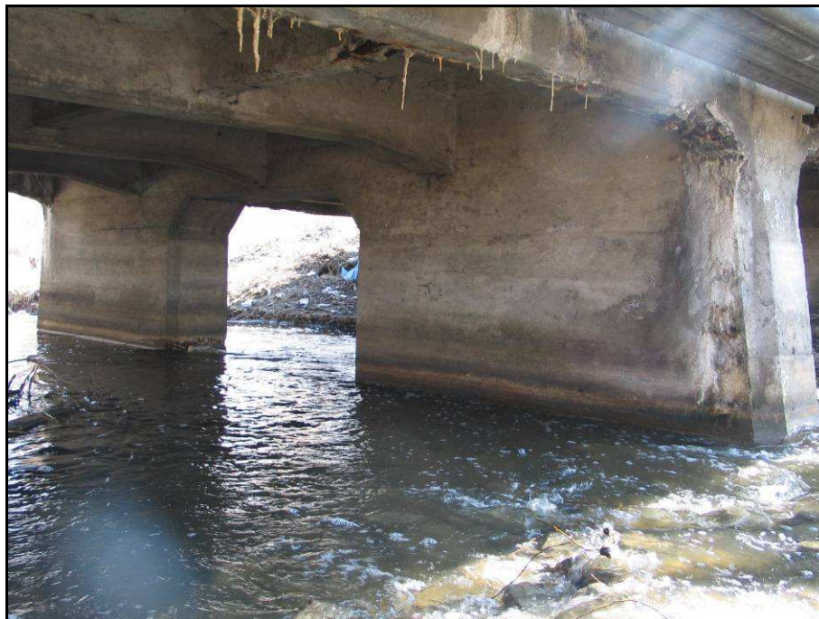
Fot. 15. Widok na podporę pośrednią od strony centrum Tarczyna. Zacieki wody i wykwyty wapienne na powierzchni filara, spowodowane przeciekami wody przez płytę pomostu.
