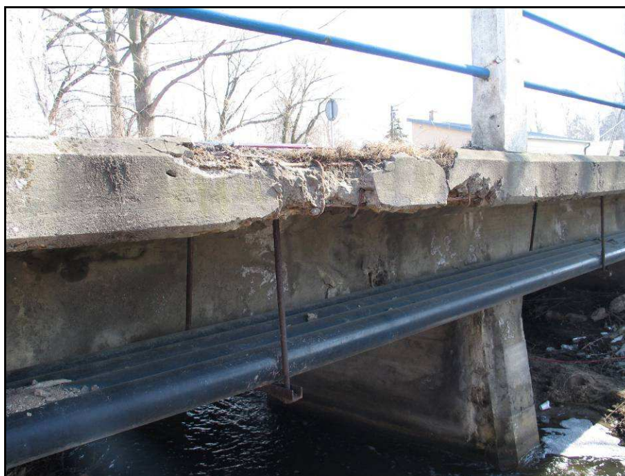
Fot. 10. Duży ubytek betonu odsłaniający skorodowane pręty na belce skrajnej od strony GW.
