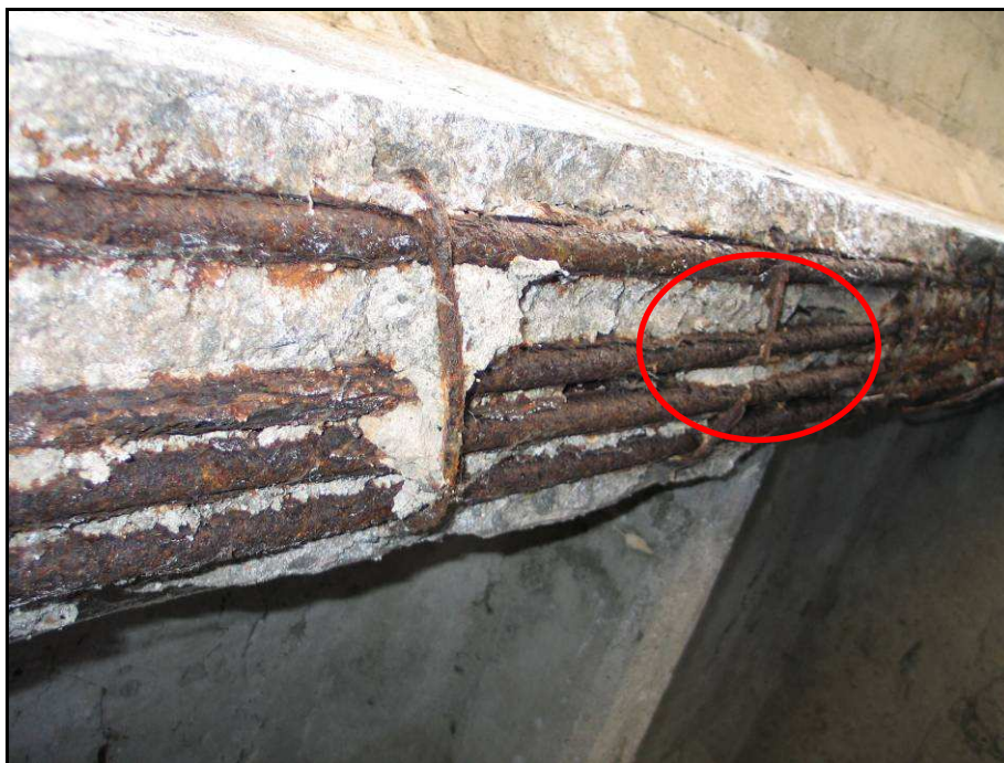
Fot. 18. Przerwane strzemie w wyniku silnej korozji stali zbrojeniowej.
