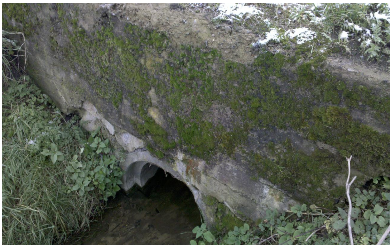
Fot. 6. Widok od strony wschodniej. Korozja biologiczna, ubytki betonu, liczne spękania.
