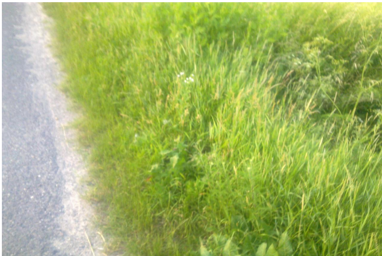
Fot. 5. Pobocze od strony zachodniej. Pobocze na całej szerokości porośnięte trawą, delikatne zanieczyszczenia jezdni gruntem.
