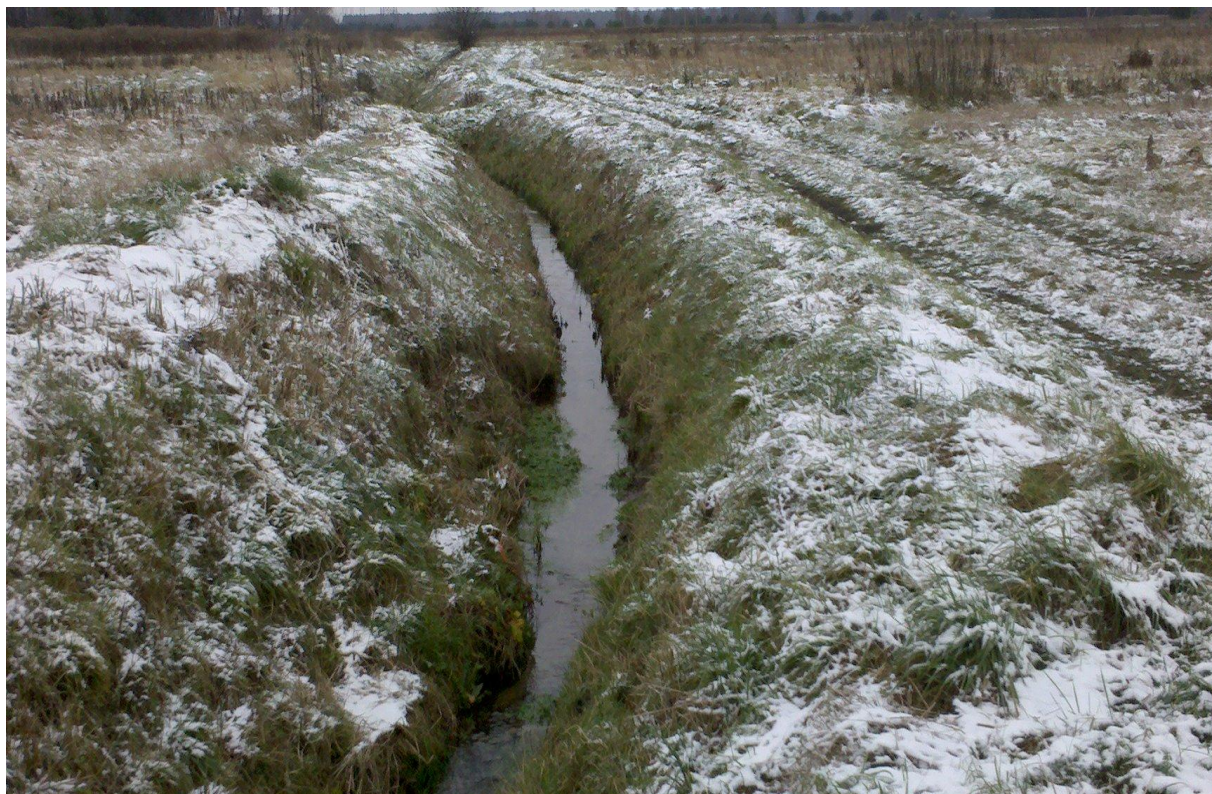
Fot. 11. Ciek od strony zachodniej w okresie zimy. Brak nieprawidłowości.
