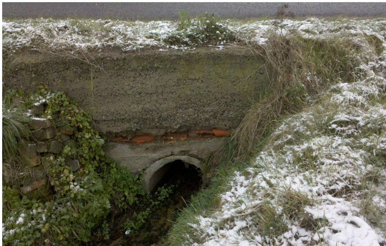
Fot. 7. Ścianka od strony zachodniej. Umocnienie skarpy ciek. Ubytki betonu, liczne spękania.
