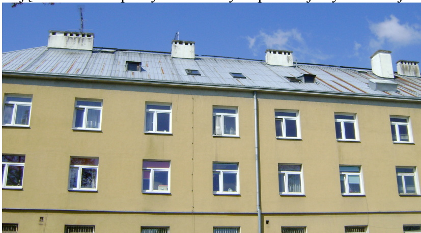
Zdjęcie nr.2- stan pokrycia z blachy trapezowej ocynkowanej
