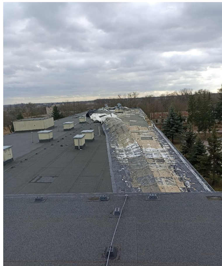
Uszkodzony dach w Zespole Szkół Zawodowych w Górze Kalwarii przy ul. Białka.
