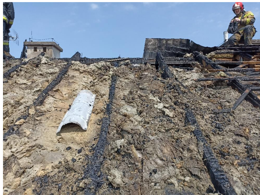
Pożar budynku mieszkalnego w Mysiadle przy ul. Borówki.
